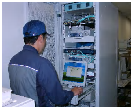
* 通信設備検査
