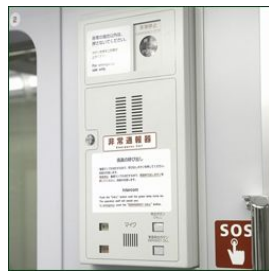
非常通報器・非常停止ボタン
