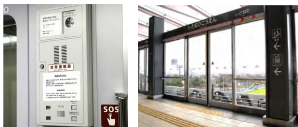
非常通報器・非常停止ボタン（左）、ホームドア（右）
