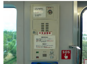
非常通報器・非常停止ボタン
