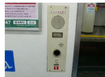
非常通報器（車内インターホン）
