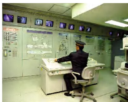
▲防災監視盤（大江戸線：駅）
