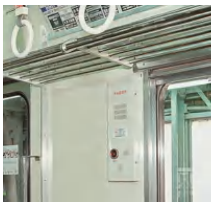
▲非常通報器（三田線）
