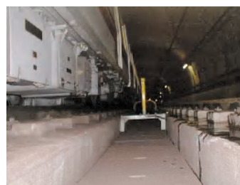
▲限界支障検知器
