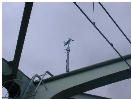
▲新宿線荒川橋梁に設置した風速計
