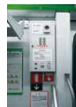
非常通報器・非常停止ボタン
