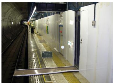
写真１ 南行線ホーム 仮囲い鋼製パネル転倒状況（推定）
