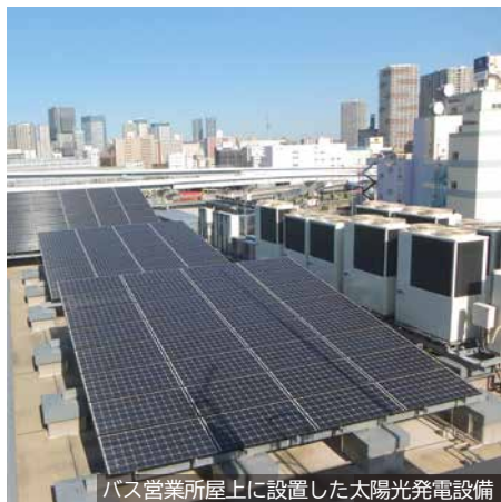
バス営業所屋上に設置した太陽光発電設備
