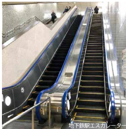
地下鉄駅エスカレーター
