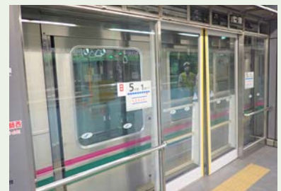
ホームドア損傷
