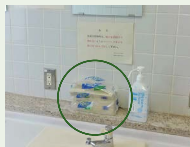
洗面台(ペーパータオル設置)
