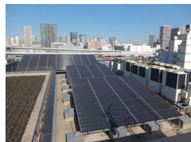
太陽光発電設備
