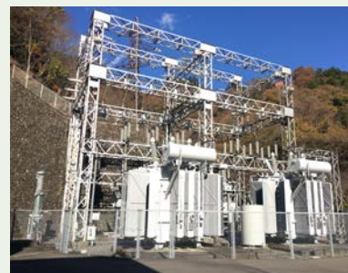
変圧器(多摩川第一発電所)
