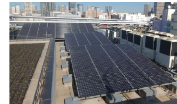
▲ 太陽光発電設備
