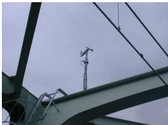
▲新宿線荒川橋梁に設置した風速計
