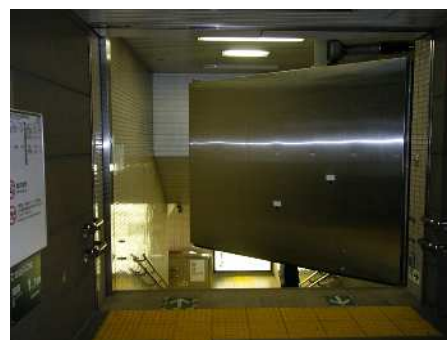
▲駅出入口の防水扉
