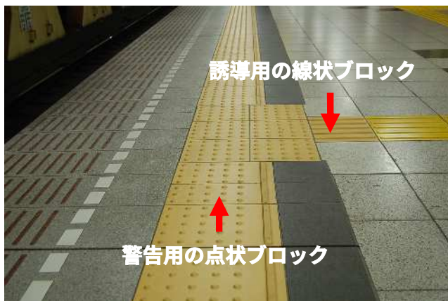
▲誘導・警告用のブロック
