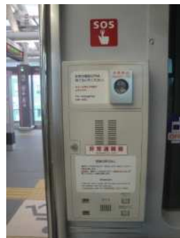
▲非常通報器 （日暮里・舎人ライナー）
