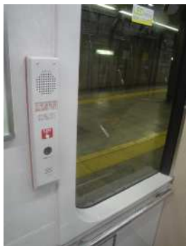
▲非常通報器（新宿線）
