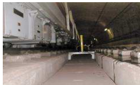
▲限界支障検知器
