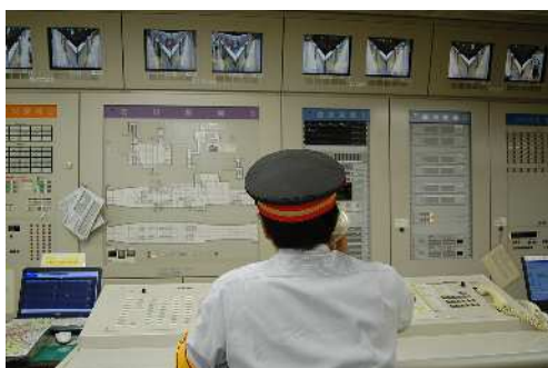
▲防災監視盤（大江戸線都庁前駅）
