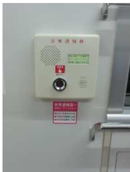
▲非常通報器（大江戸線）
