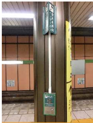
▲駅係員呼出インターホン
