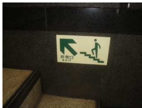
▲蓄光式避難誘導明示物
