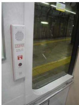
▲非常通報器（新宿線）
