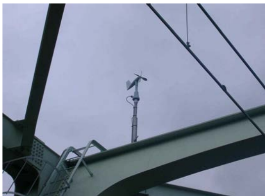
▲新宿線荒川橋りょう部に設置した風速計
