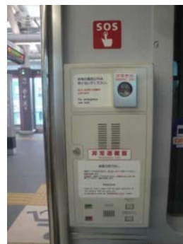
▲非常通報器 （日暮里・舎人ライナー）
