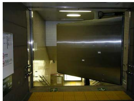
▲駅出入口の防水扉
