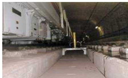
▲限界支障検知器
