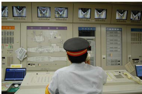
▲防災監視盤（大江戸線都庁前駅）
