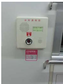
▲非常通報器（大江戸線）
