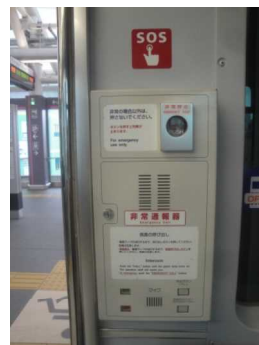
▲非常通報器 （日暮里・舎人ライナー）
