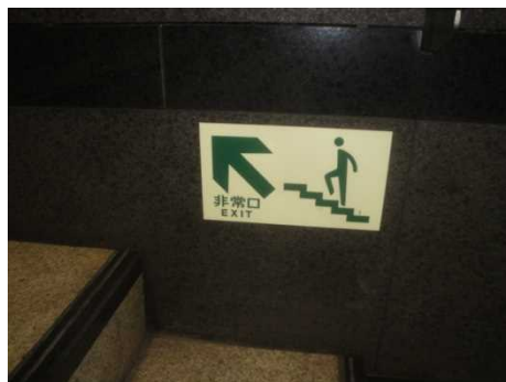
▲蓄光式避難誘導明示物
