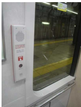
▲非常通報器（新宿線）
