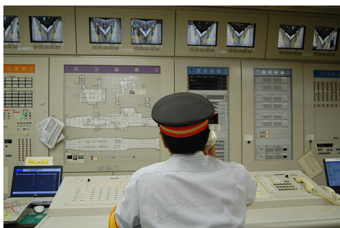
▲防災監視盤（大江戸線都庁前駅）
