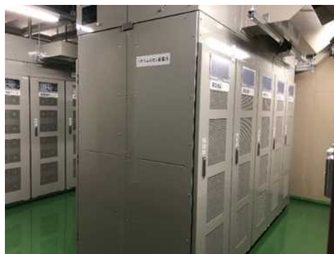
▲電力貯蔵設備
