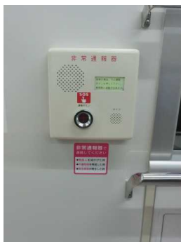
▲非常通報器（大江戸線）
