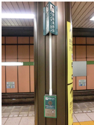
▲駅係員呼出インターホン
