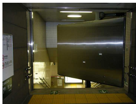
▲駅出入口の防水扉
