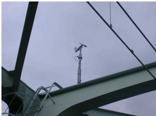
▲新宿線荒川橋りょうに設置した風速計
