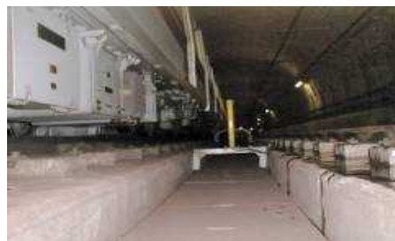
▲限界支障検知器
