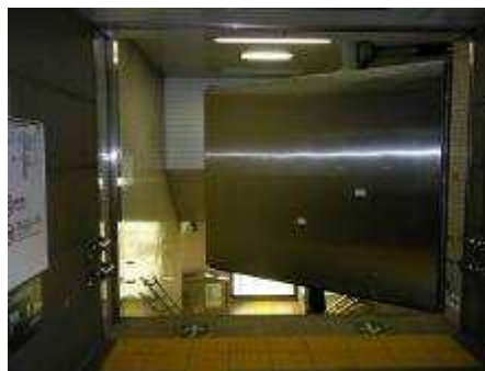
▲駅出入口の防水扉
