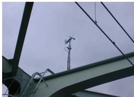
▲新宿線荒川橋りょう部に設置している風速計
