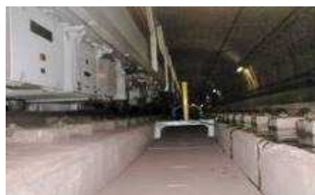
▲限界支障検知器
