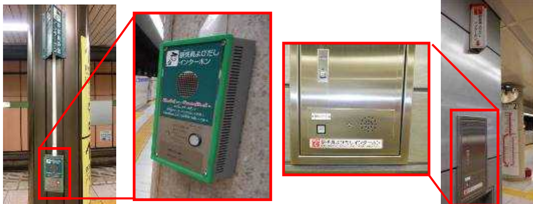
▲駅係員呼出インターホン
