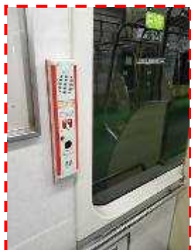
▲非常通報器（新宿線）
