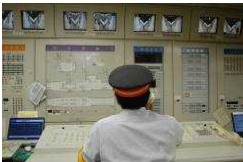
▲防災監視盤（大江戸線都庁前駅）
