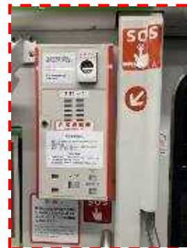
▲非常通報器 （日暮里・舎人ライナー）
