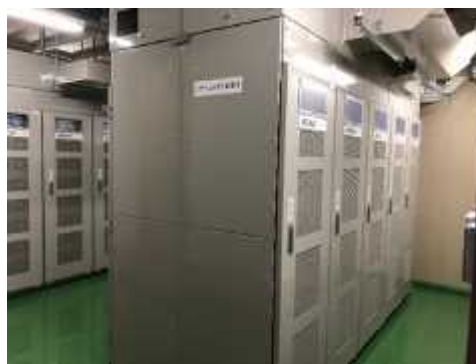
▲電力貯蔵設備
