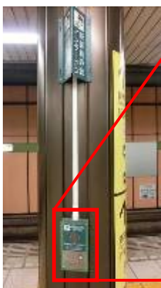
▲駅係員呼出インターホン
