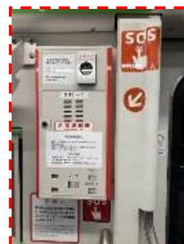
▲非常通報器 （日暮里・舎人ライナー）
