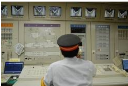
▲防災監視盤（大江戸線都庁前駅）
