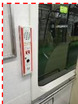
▲非常通報器（新宿線）
