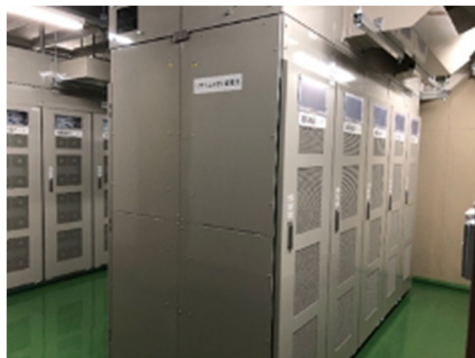
▲電力貯蔵設備
