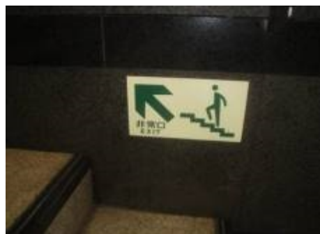
▲蓄光式避難誘導明示物
