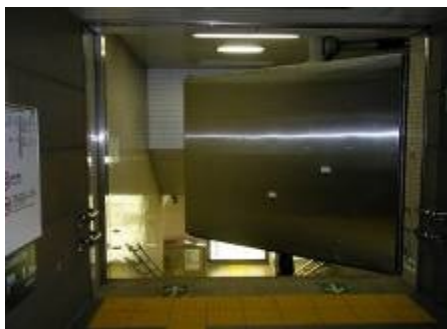
▲駅出入口の防水扉
