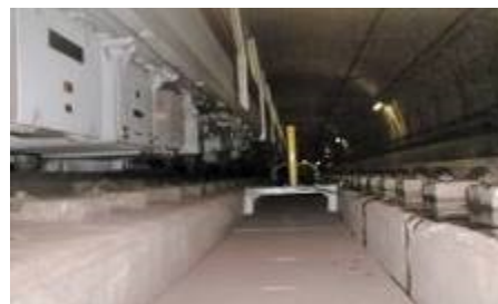
▲限界支障検知器
