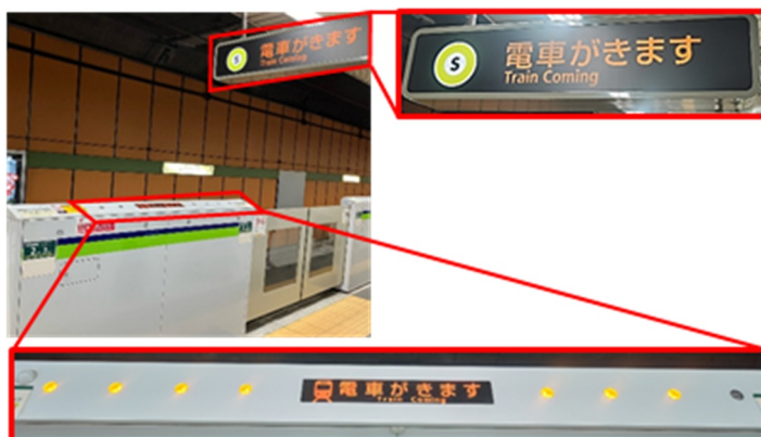
▲地下鉄各線接近表示器
