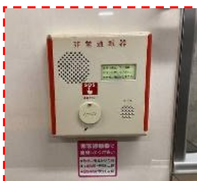
▲非常通報器（大江戸線）
