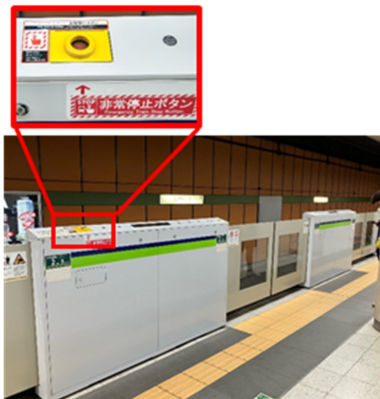
▲地下鉄各線ホームドア
