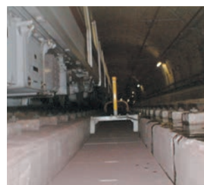
▲限界支障検知器
