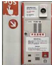
▲非常通報器と非常停止ボタン
