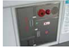
▲自動火災報知設備、消火器、連結送水管設備
