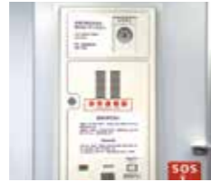
▲非常通報器と非常停止ボタン
