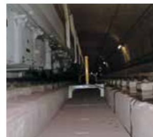
▲限界支障検知器
