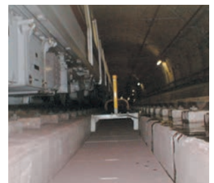
▲限界支障検知器
