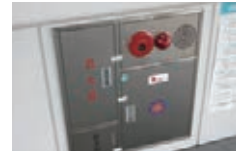
▲自動火災報知設備、消火器、連結送水管設備
