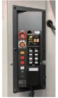
▲列車無線装置
