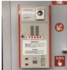
▲非常通報器と非常停止ボタン
