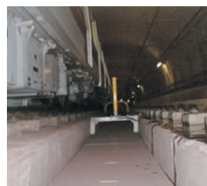
▲限界支障検知器
