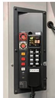
▲列車無線装置
