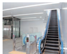
▲エレベーター・エスカレーター
