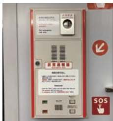
▲非常通報器と非常停止ボタン
