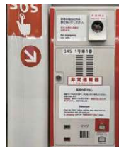
▲非常通報器と非常停止ボタン
