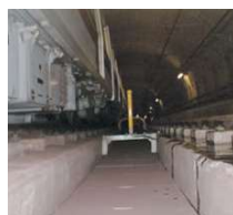
▲限界支障検知器
