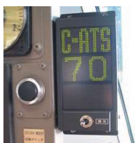
▲C-ATS運転台の表示器
