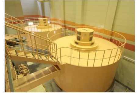
多摩川第三発電所
