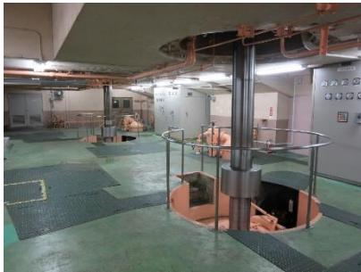
多摩川第一発電所
