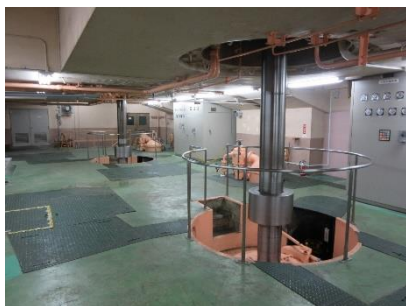
多摩川第一発電所
