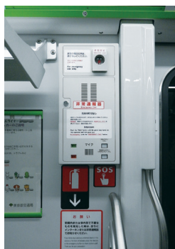
非常通報器・非常停止ボタン
