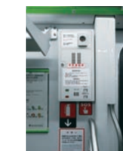
非常通報器・非常停止ボタン
