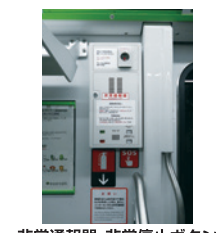
非常通報器・非常停止ボタン
